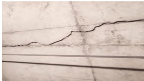
图7 衬砌裂缝病害现场图
